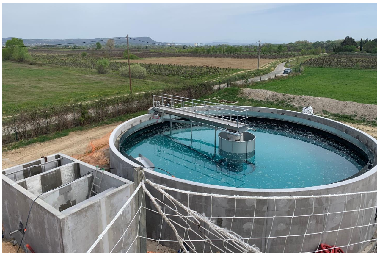
Bassin clarificateur de la station d'épuration de Laudun - Village
